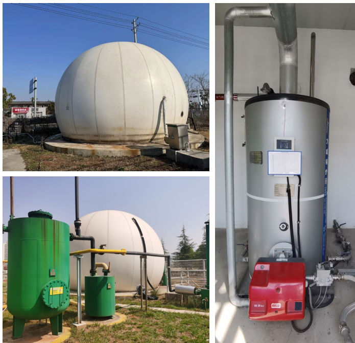
沼气囊与沼气热水锅炉
